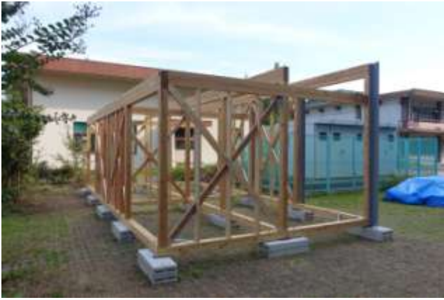
(8)間柱・筋違(杉 1 等)、外壁材落とし込みガイド金物(東側)設置
